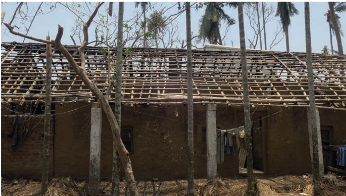
Enorme Schäden an den einfachen Behausungen.
